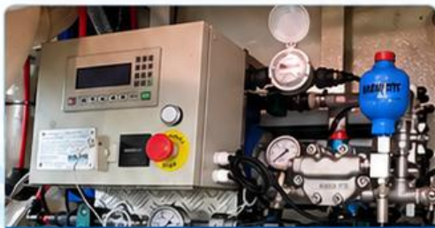
Máquina instalada (ejemplo 1)
