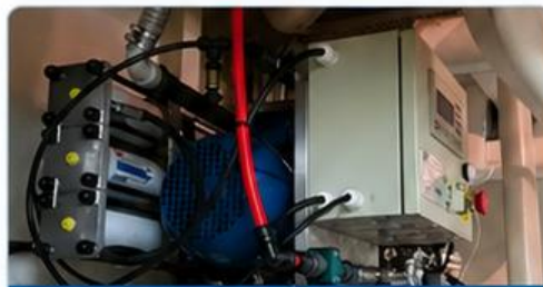
Máquina instalada (ejemplo 2)
